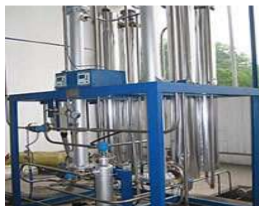
Рис. 2 – Приклад сучасного обладнання виробництва водню – комплексна система
