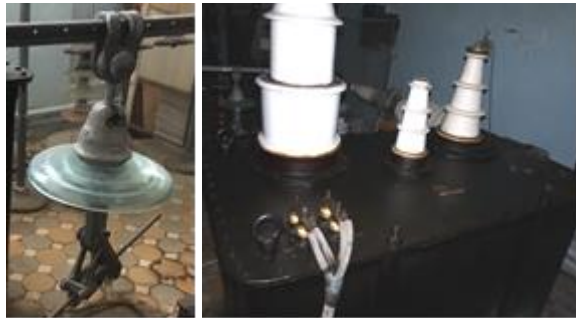
Рисунок 1 – Ізолятор (зліва), підвищувачи трансформатор (справа)
