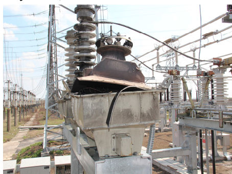
Рис. 2 – Пошкоджені в 2015 році трансформатор напруги 35 кВ (2014 року випуску)
