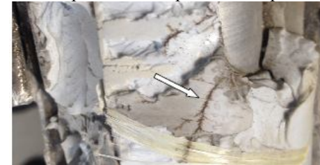
Рис. 1 – Следы электрических разрядов
