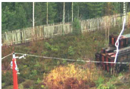
Рисунок 7 – Разряд грозового импульса в изолированный провод линии 10кВ с УЗАП-0 на траверсе
