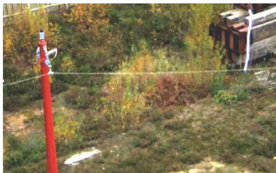
Рисунок 11 – Разряд грозового импульса в изолированный провод линии 10кВ с УЗАП-К на траверсе
