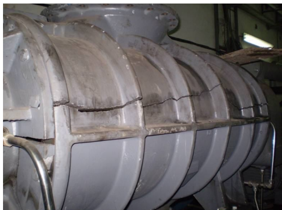
Рис.1 Разрушение корпуса насоса
