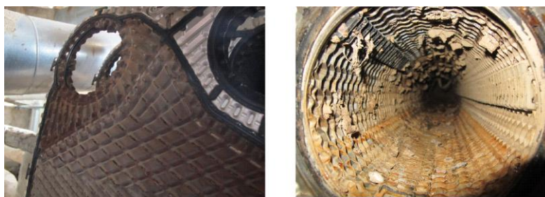
а) б) Рисунок 2 – Загрязнение теплообменников 1-й и 2-й ступеней: а – распределительного участка; б – коллектора
