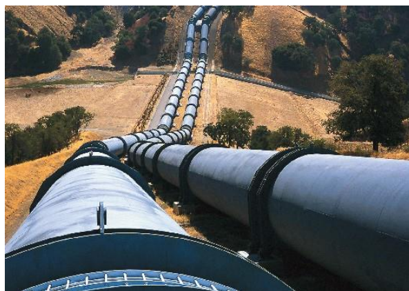
Рисунок 6 – Одна із ділянок газопроводу Дашава – Київ
