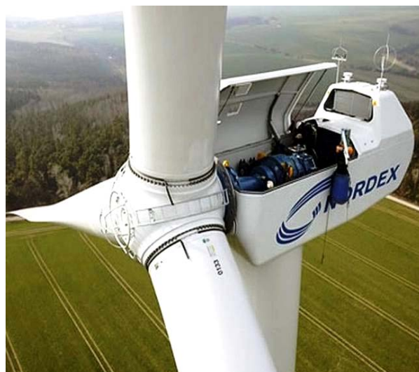
Рис. 4. Укрупненный вид турбины современной горизонтально-осевой трехлопастной ВЭУ марки NORDEX установленной мощностью до 1500 кВт сухопутного базирования в период ее техобслуживания на высоте около 70 м [11]
