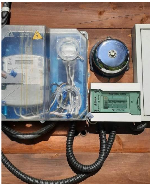
Рис.7. Підключення бензинового генератора до локальної електромережі 380 В
